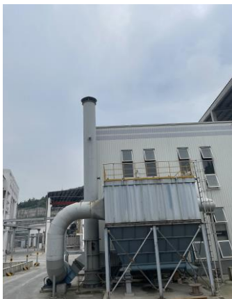
磷矿粗碎废气布袋除尘及排放口
