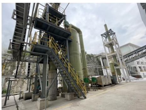
熔硫废气处理水洗塔和排气筒
