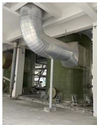
高档阻燃废气处理设施水洗塔
