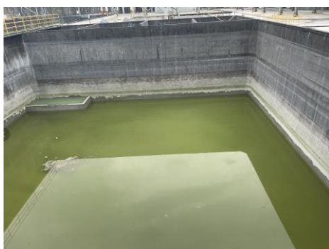
事故池旁4500m 3 初期雨水收集池
