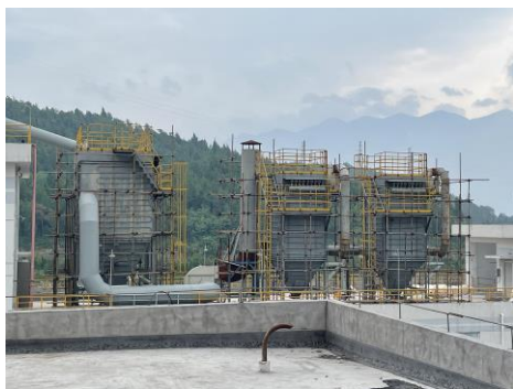
多元肥、硫基/硝硫基、氯基包装废气布袋除尘和排气筒
