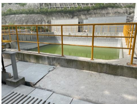
中档阻燃装置旁587 m 3 初期雨水收集池
