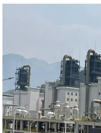
多元素、氯基、硫基废气静电除尘
