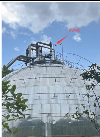
液氨储罐区风向标
