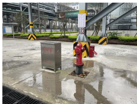
综合罐区设高压消防栓
