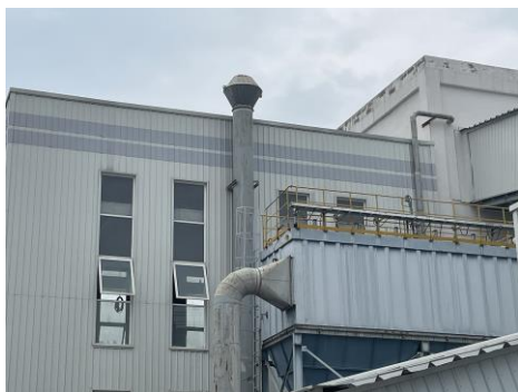
磷矿细碎布袋除尘及排放口
