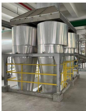
磷酸二氢钾废气处理设施旋风分离器
