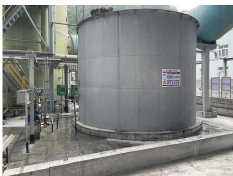
双氧水储罐围堰35m 3
