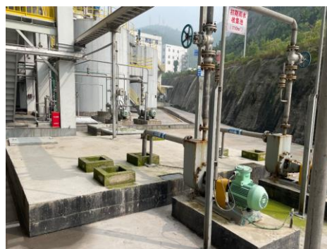
磷酸二氢钾装置旁110 m 3 初期雨水收集池
