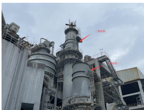
湿法磷酸废气两级水洗塔
