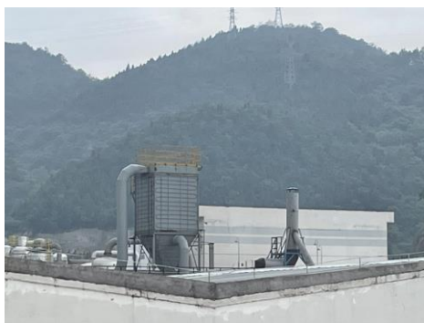
高阻燃、二氢钾包装废气布袋除尘和排气筒
