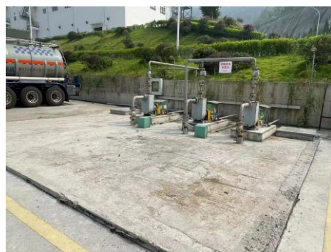
磷酸净化装置旁250m 3 初期雨水收集池
