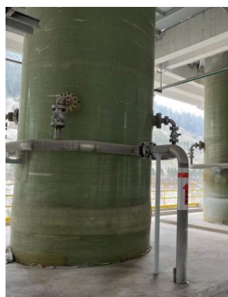
磷酸二氢钾废气处理设施水洗塔
