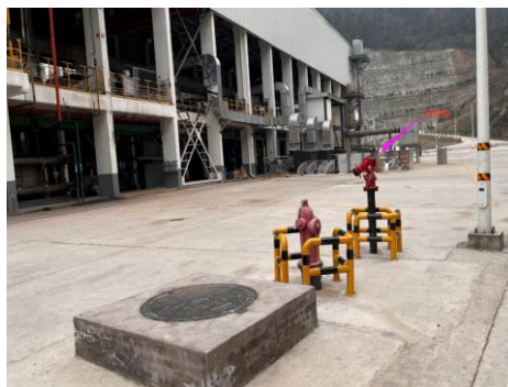
合成氨装置区消防水炮
