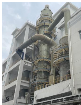
中档阻燃废气处理设施水洗塔
