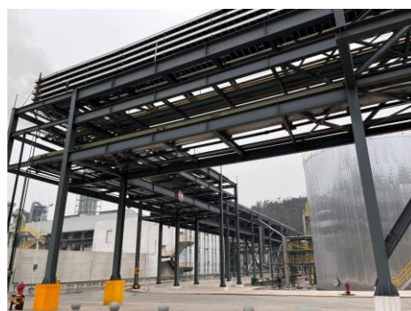
废水可视化管廊
