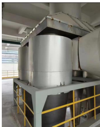
高档阻燃废气处理设施旋风分离器
