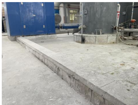
包裹油槽围堰有效容积5m 3
