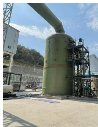
磺制酸尾气双氧水洗涤塔
