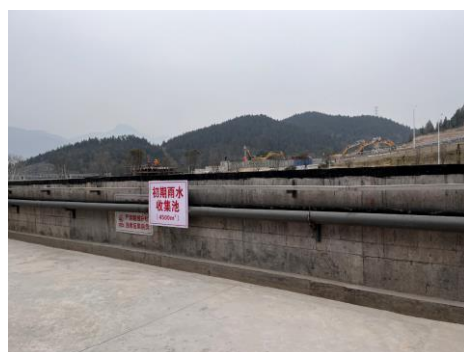
事故池旁4500m 3 初期雨水收集池
