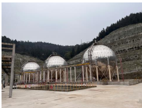
液氨储罐喷淋系统及初期雨水收集池
