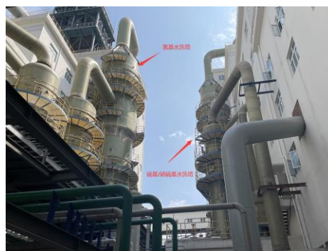
氯基、硫基/硝硫基肥废气处理水洗塔
